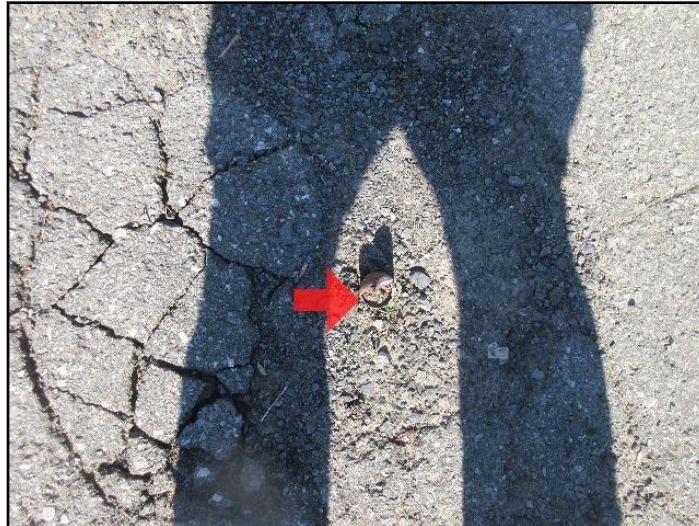
11. Uneven (trip hazard)
